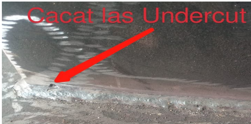
Gambar 5. Cacat Las Undercut
